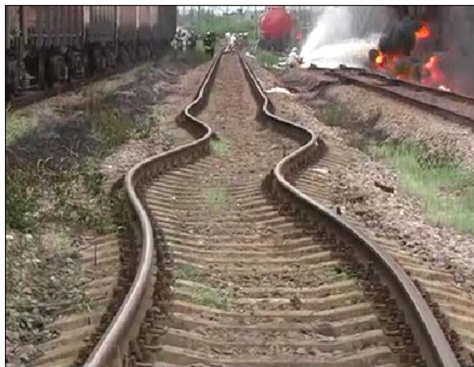
Рис. 3. Деформация рельс в результате воздействия высоких температур при пожаре вагонов
